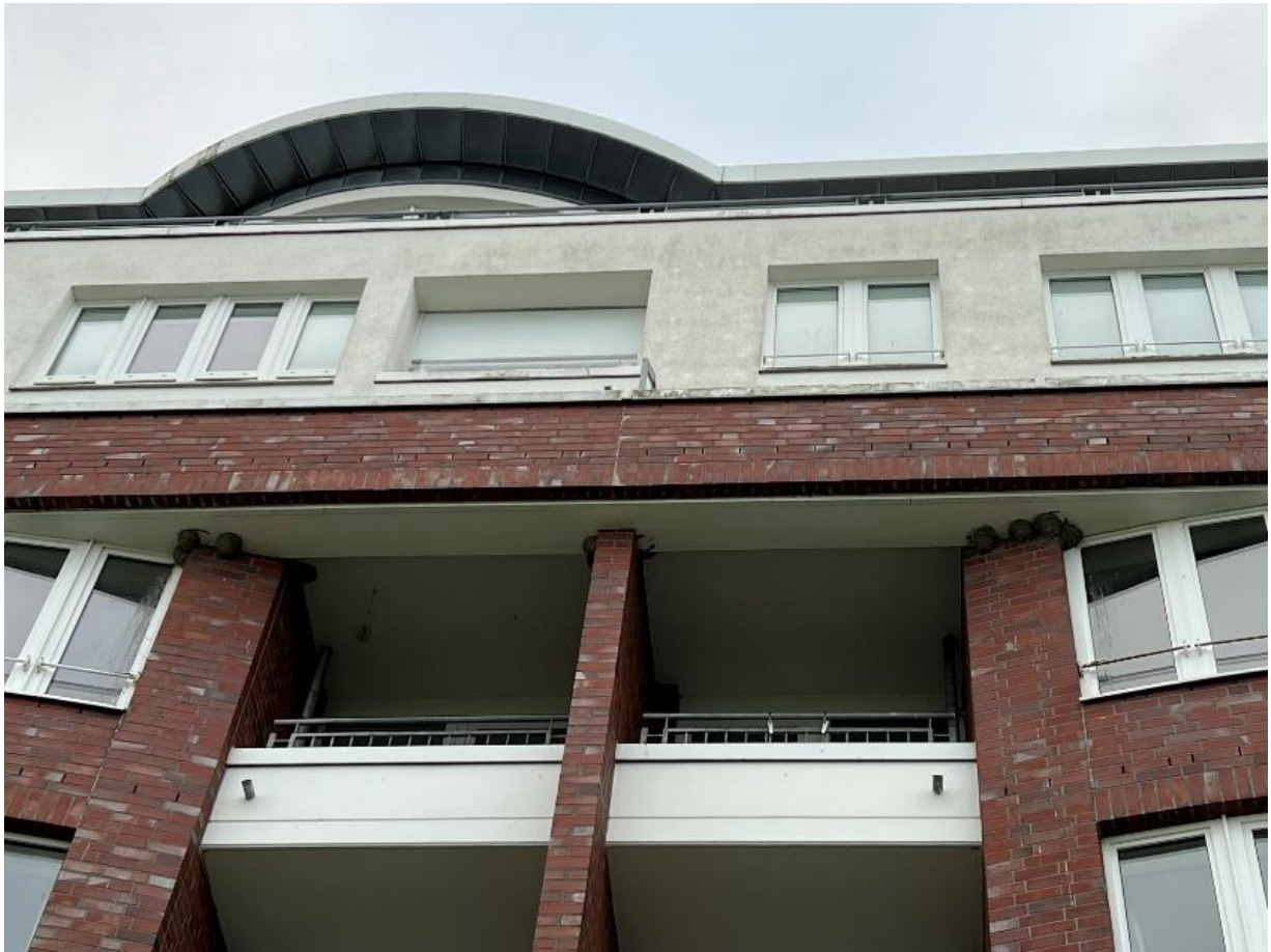
Abbildung 6: Mehlschwalben-Nester an der Fassade
